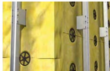
Materiales aislantes debajo de fachada ventilada
