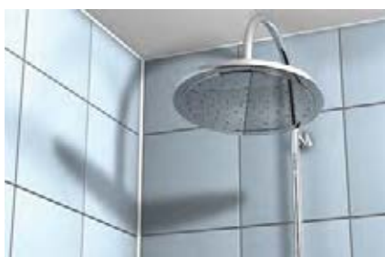
Juntas en baños
