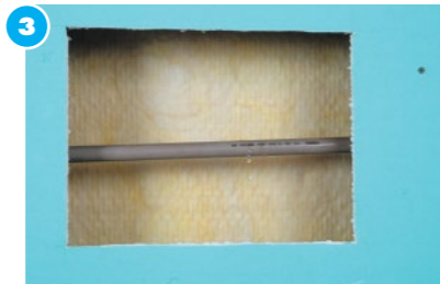
3 Reparación de las instalaciones Retire el corte de placa dañado y verifique la instalación. Repare la pérdida y controle si hay más agua en el interior de la pared/revestimiento. En tal caso, deje secar por completo
