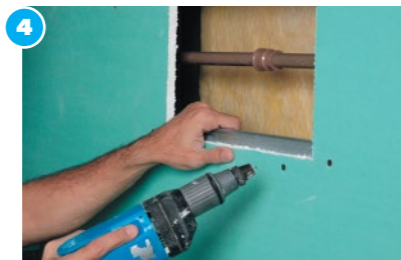
4 Fijación del perfil de refuerzo Después de la reparación, comience con la recomposición de la superficie, fijando dentro de la pared/revestimiento recortes de perfiles en la parte superior e inferior o en los lados de la perforación, como muestra la figura, fijándolos con tornillos punta aguja autoperforantes.
