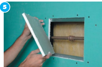
5 Instalación del nuevo recorte de placa Recorte una porción de placa del tamaño de la perforación. En este caso la placa que se debe usar es la IMP (placa verde) debido al pasaje de cañería con fluidos líquidos por el interior de la pared/revestimiento.
